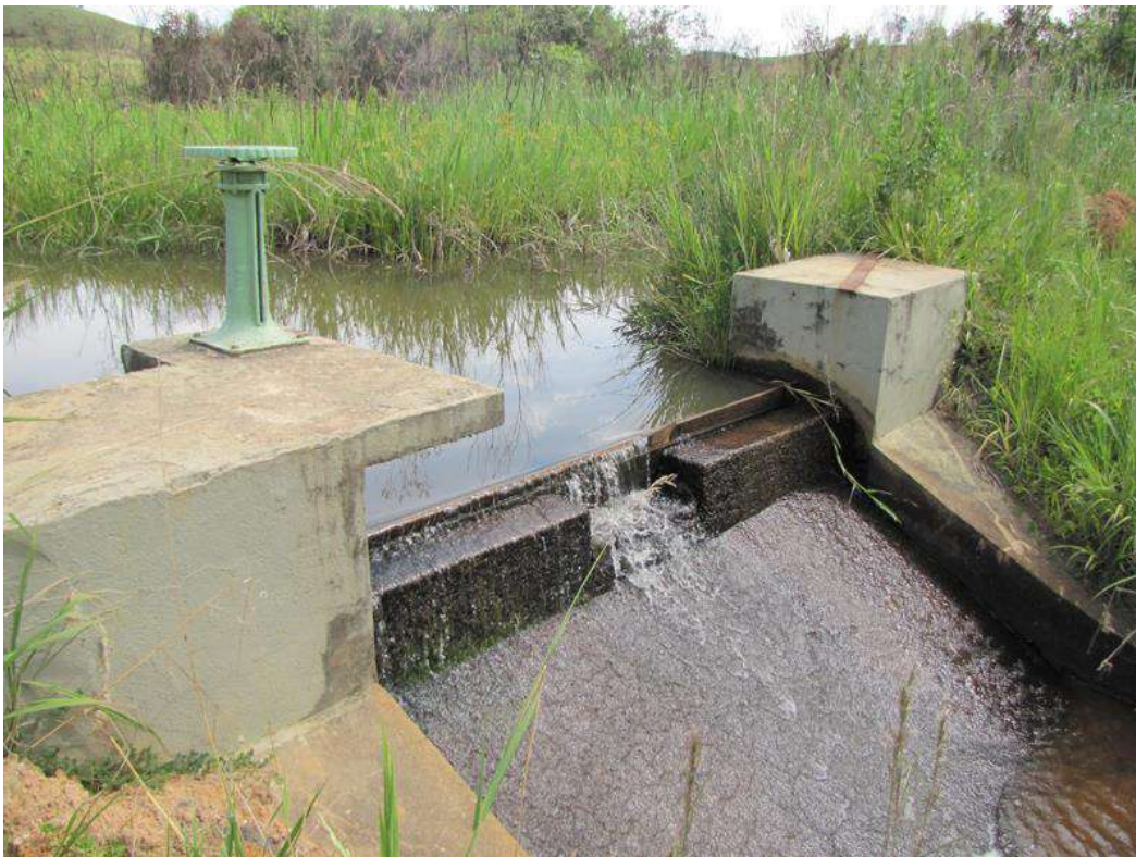
Figura 87 - Captação no Córrego do Vau Fonte: Moradores de Carandaí, 2015.
