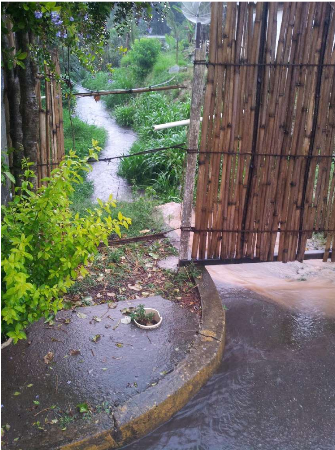
Figura 40 - Lançamento de esgoto na área urbana de Hermilo Alves Fonte: SAMENCO, 2014.
