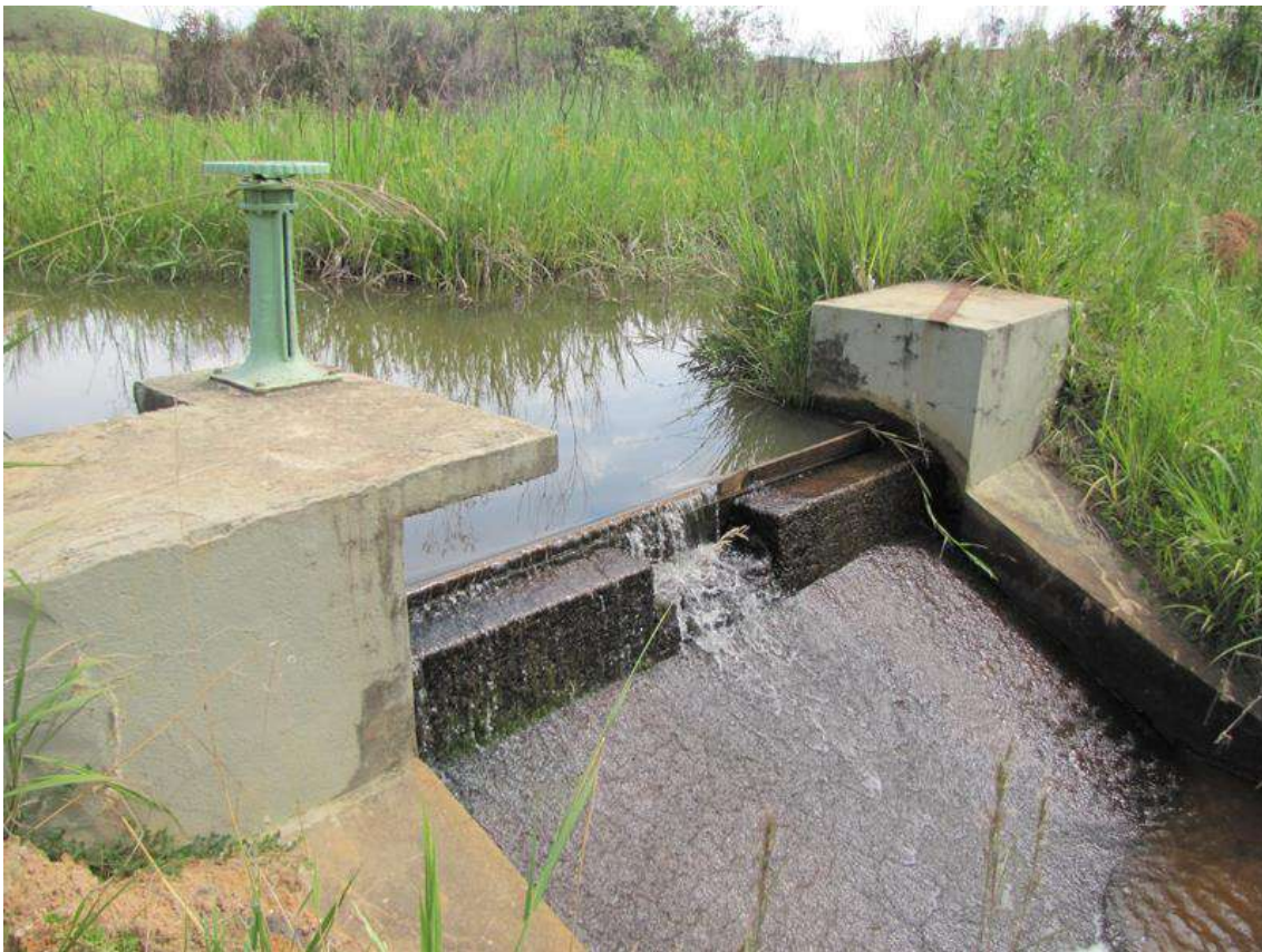
Figura 14 - Captação no Córrego do Vau Fonte: Moradores de Carandaí, 2015.
