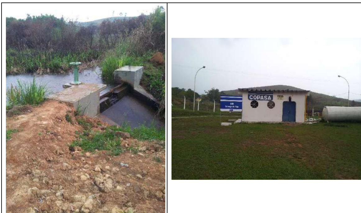
Figura 24 - Captação no Córrego do Vau Fonte: SAMENCO, 2014
